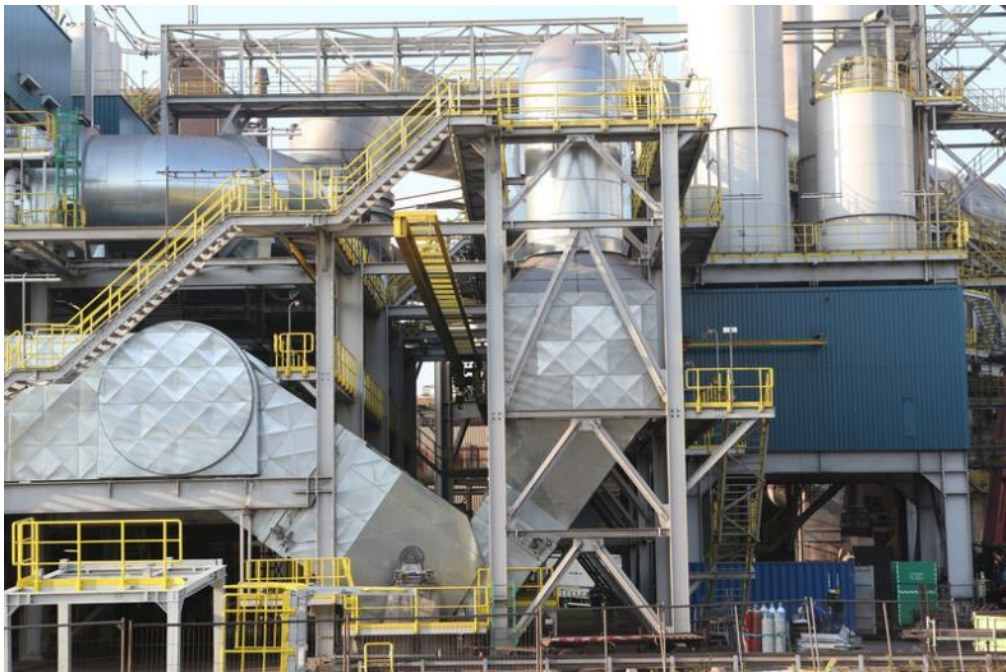
Figuur 4.2 De Doekfilterinstallatie (bron: Tata Steel)
