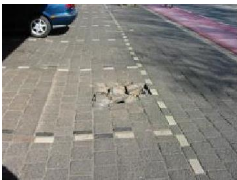
Foto: schade aan verharding
