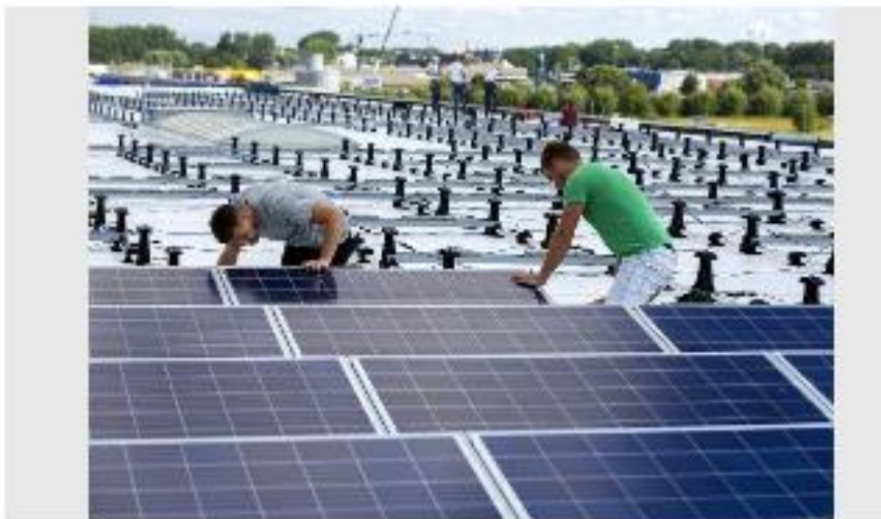
Het distributiecentrum van Vomar in Alkmaar staat sinds 2018 vol met zonnepanelen.
